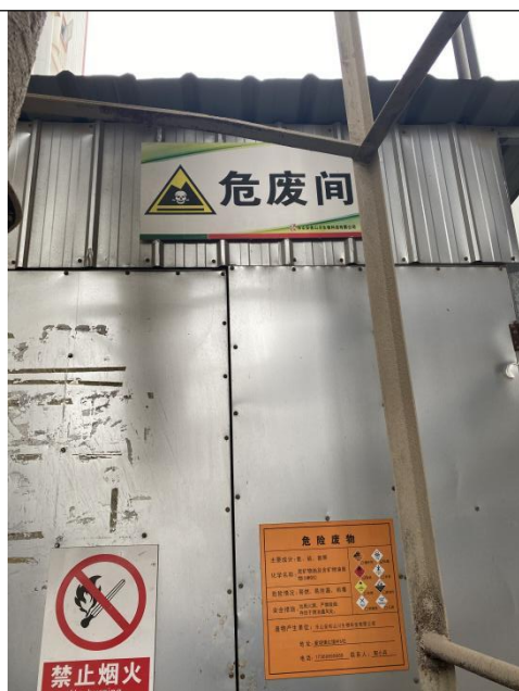
危废间标识牌不规范、不完善
