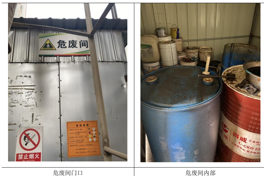
图 2-8 现有工程危废暂存间照片
