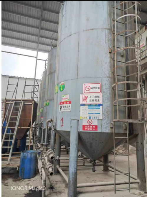
豆油筒仓未设置围堰
