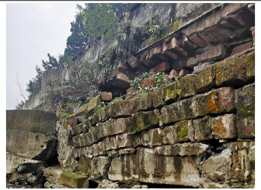
909宿舍区外跨塌处
