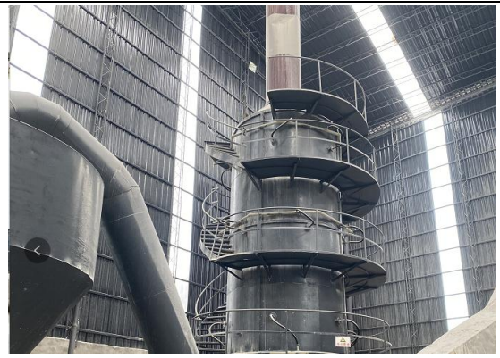
喷淋塔+沉淀池
