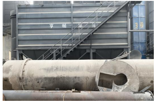
出料口布袋除尘器
