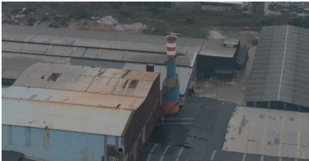
脱硫塔排气口
