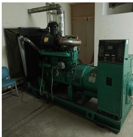
柴油发电机房现状照片 (需整改)
