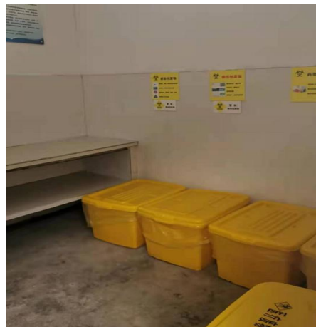
医疗废物暂存间现状照片 (需整改)
