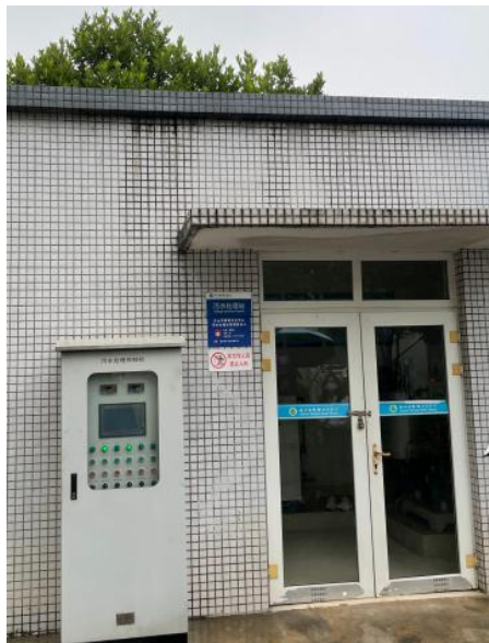
污水处理站照片
