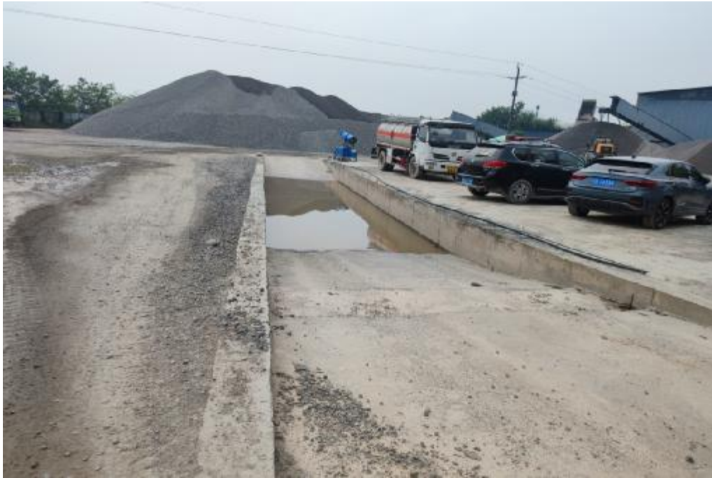
图 3.6-6 项目大门旁的洗车槽
