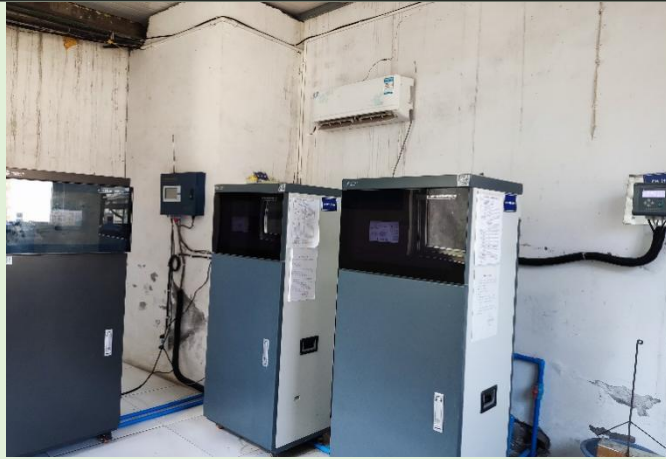
废水治理措施、在线监测设备
