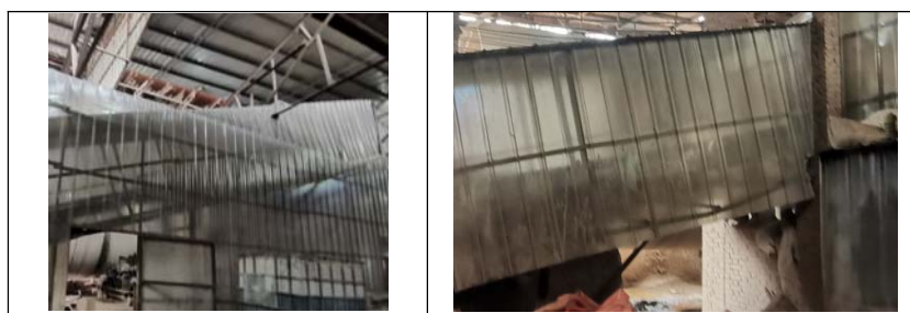
原料输送粉尘治理措施
