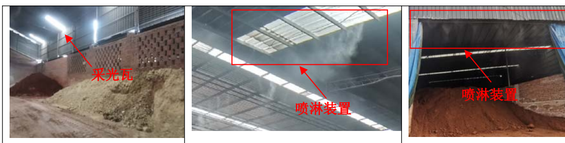
原料库房及装卸扬尘治理措施
