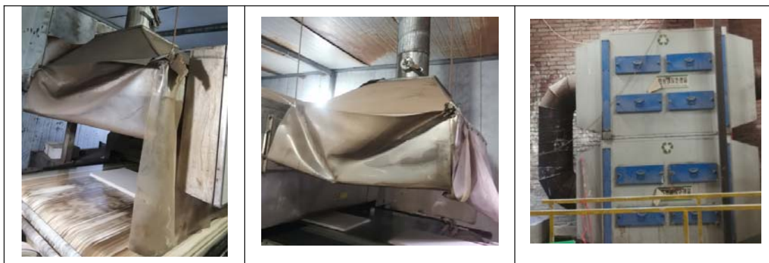
印刷有机废气治理措施
