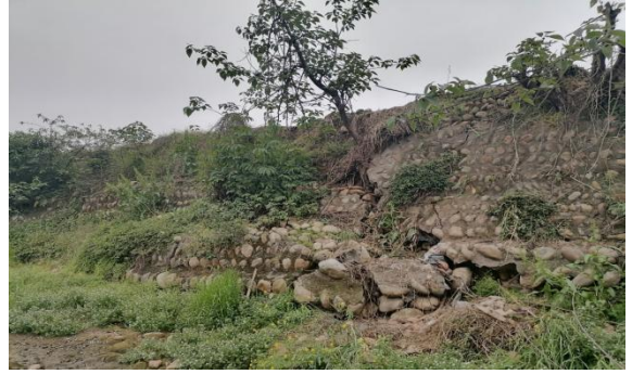
原砂卵石堤防垮塌，堤脚冲刷
