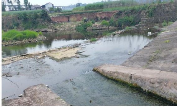
新建堤防段原浆砌卵石堤防垮塌段
