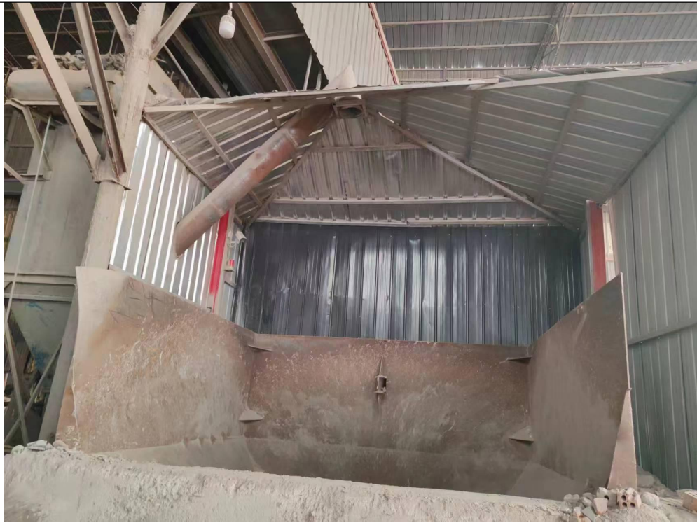
破碎系统进料口（现有项目情况）
